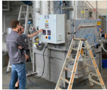
Heger Edelstahl baut Wärme- rückgewinnungsanlagen. Foto: Heger
