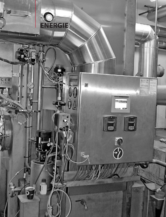
Kompakte Wärmerückgewinnung: Kondensationsanlage von Heger Edelstahl
