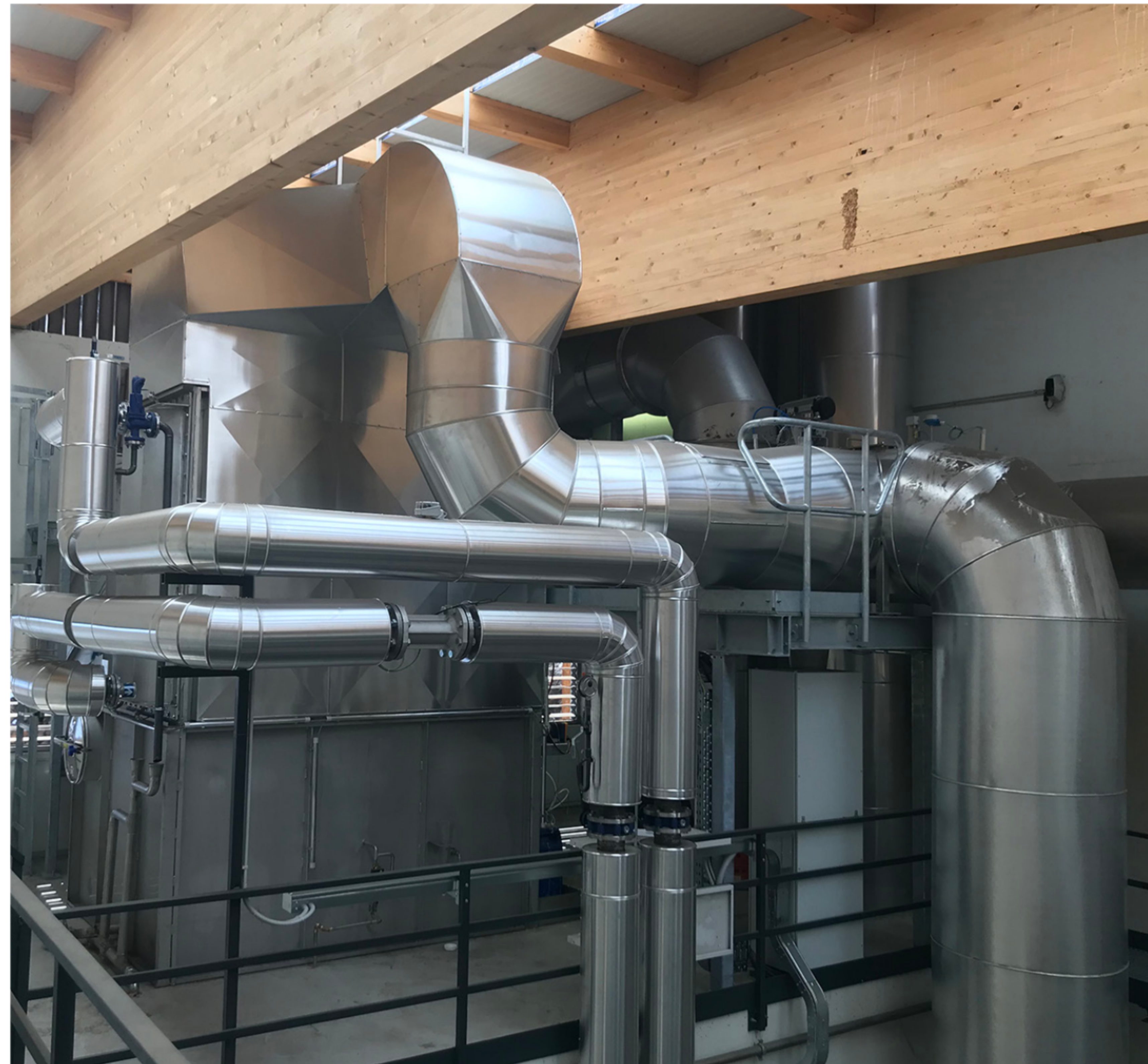
Mittels Rauchgaskondensationsanlagen spart der Betreiber nicht nur Geld, sondern reduziert auch den CO 2 -Ausstoß.
