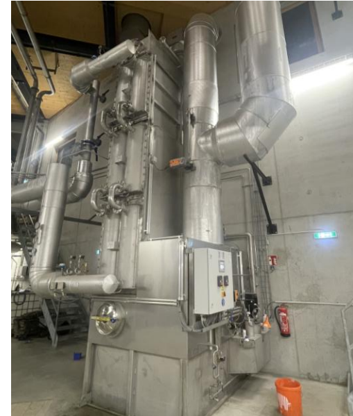
HEGC-0300-XXL nach der Warm-Inbetriebnahme
